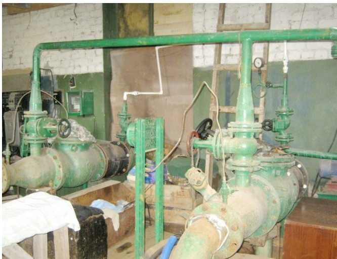
Рисунок 6.4.3 – Насосы станции 1-го подъема
