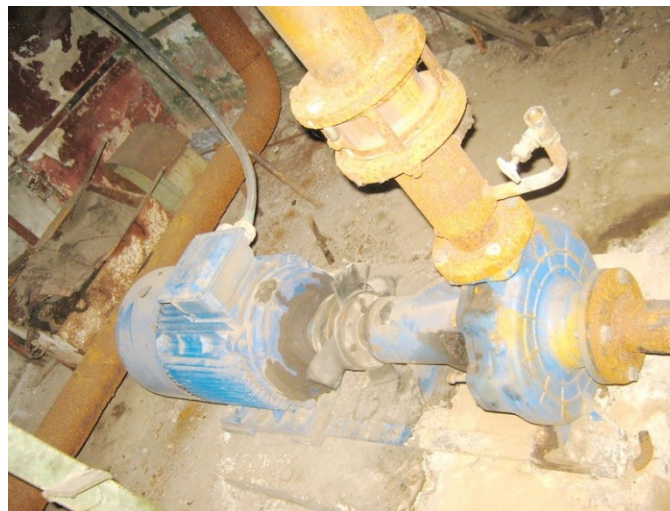
Рисунок 6.4.4 – Рабочий насос станции 2-го подъема
