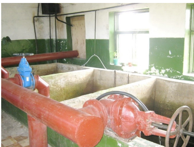
Рисунок 6.4.5 – Участок фильтрации воды фильтровальной станции
