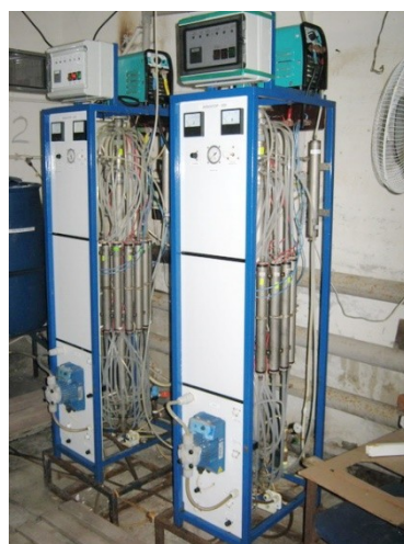
Рисунок 6.4.6 – Участок хлорирования воды фильтровальной станции
